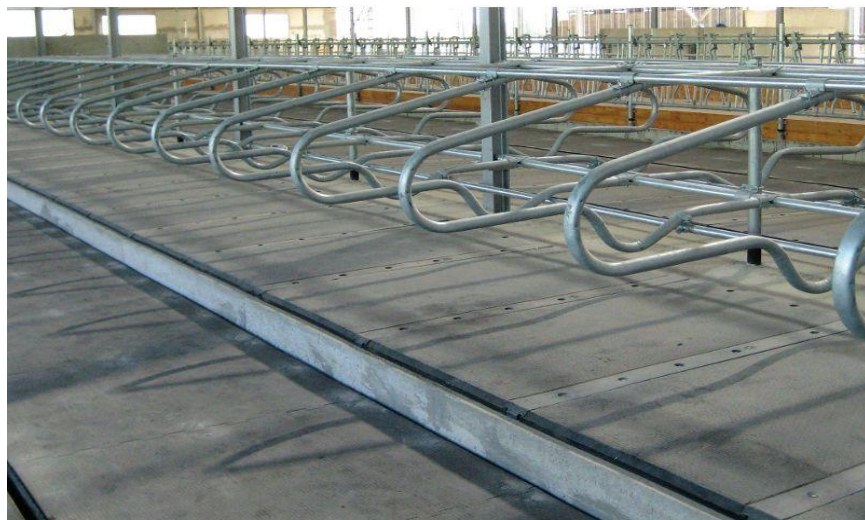
Foto z instalace
